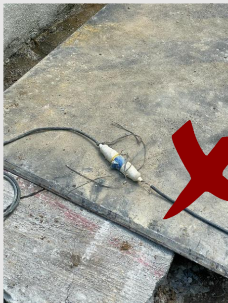
電線已明顯損壞
