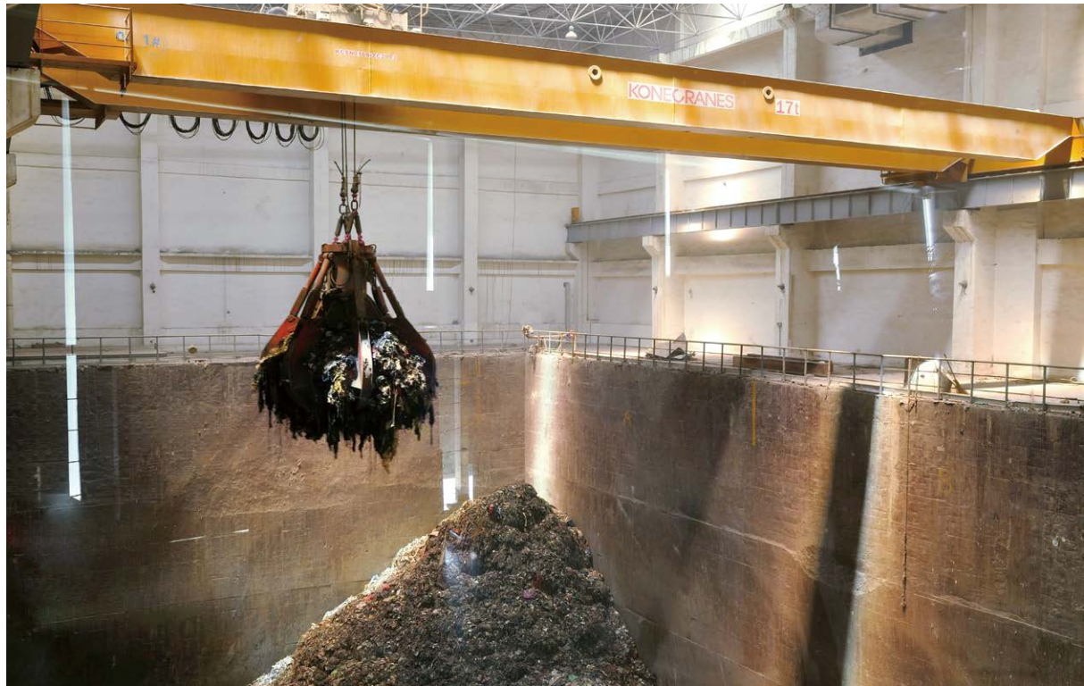
▲ 成都祥福生活垃圾焚烧发电厂内，垃圾吊的巨大抓斗正在抓取垃圾往焚烧炉里“喂料”。
