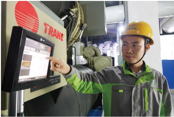
▲ 贵阳中天·未来方舟项目一号能源站采用“河水源热泵+调峰锅炉”系统，运用大温差技术、水泵变频运行技术、引入能效管理平台、智能化控制系统等，使系统高效、节能运行。图为站长周标彪正在做例行巡查。
