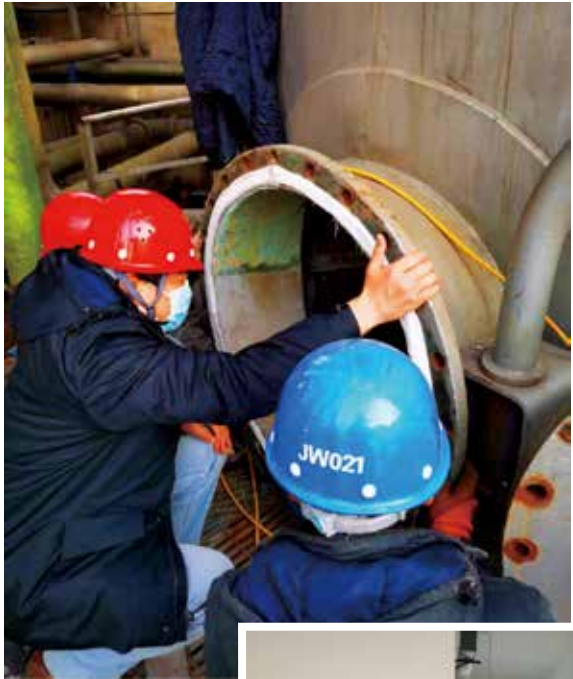
◀ 工业节能下属山西中节能潞安电力节能服务有限公司春节不停工，#3脱硫二级氧化风套管法兰浆液泄流，总经理冯浩现场制定方案。
