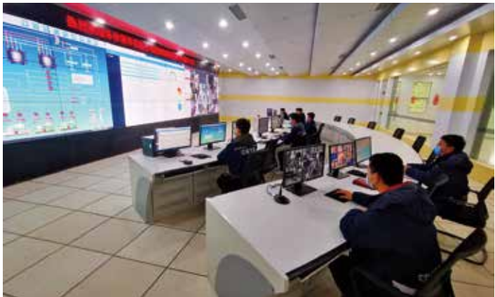
▲ 建筑节能公司下属贵州公司疫情期间不停工，员工坚守能源站中控室，实时监控供热情况。
