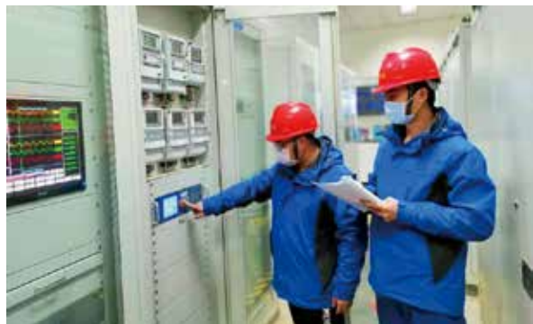
▲ 2月12日，在武汉的太阳能公司华中区党总支第一时间成立党员突击队，25名党员始终坚守岗位，8个电站在“封城”的严峻形势下未发生停电，并确保了新并网项目的试运营。
