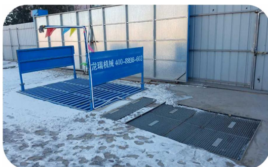
图 11 天津新通-冲车废水收集设备
